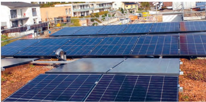
Die Stockwerkeigentümerschaft hat sich für die gemeinsame Investition in eine Photovoltaikanlage entschieden.
