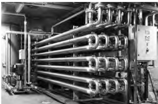
Abbildung 6: Wärmerückgewinnung aus Schmutzwasser in einer Wäscherei.
