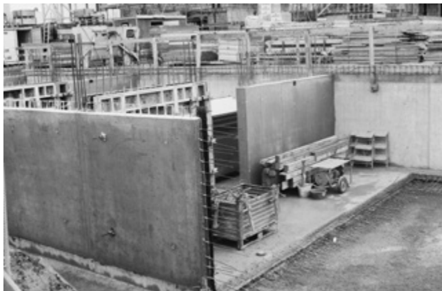
Bauen mit Recycling-Konstruktionsbeton auf einer Baustelle in Tägerwilen (Bilder: Möckli Kies, Beton, Transporte)
